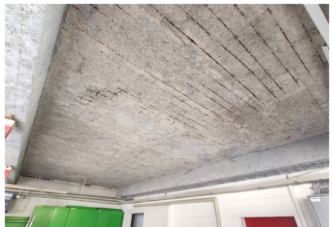
Nicht in Beton eingebettete, rostige Armierungseisen
