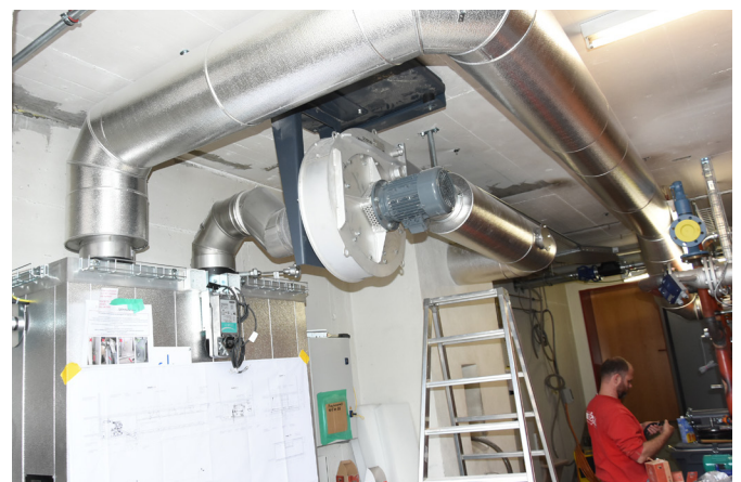
...mit den Zu- und Abluftrohren.
