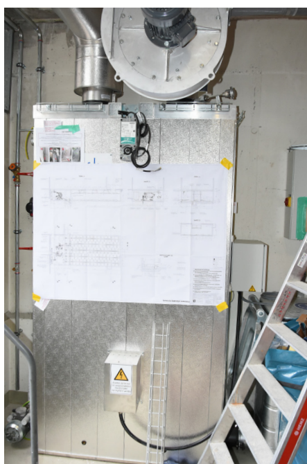
Die neue Filteranlage...
