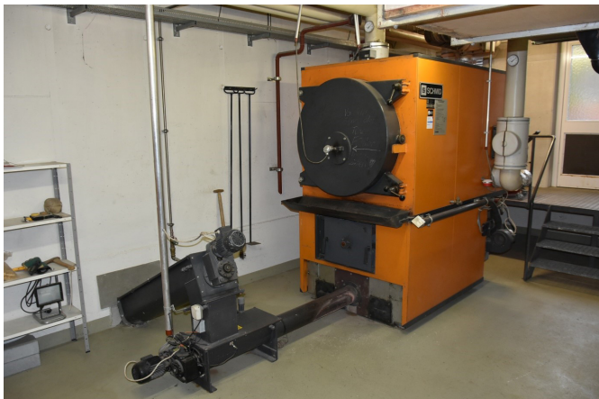
Die alte Heizungsanlage
